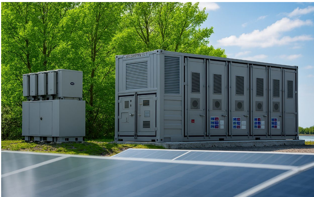
Figur 5: Eksempel på BESS-container med tilhørende kabinet til invertere og andet teknik.
